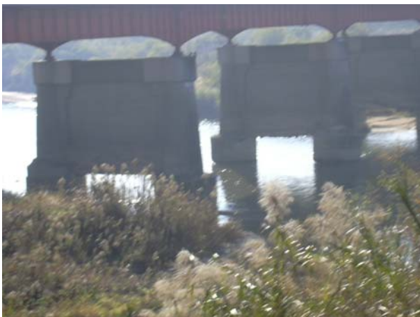
基礎部分が水面よりも上に来っており、河床が低下していることがわかります。
